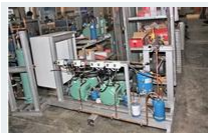
Двухкомпрессорный агрегат на отдельной раме
